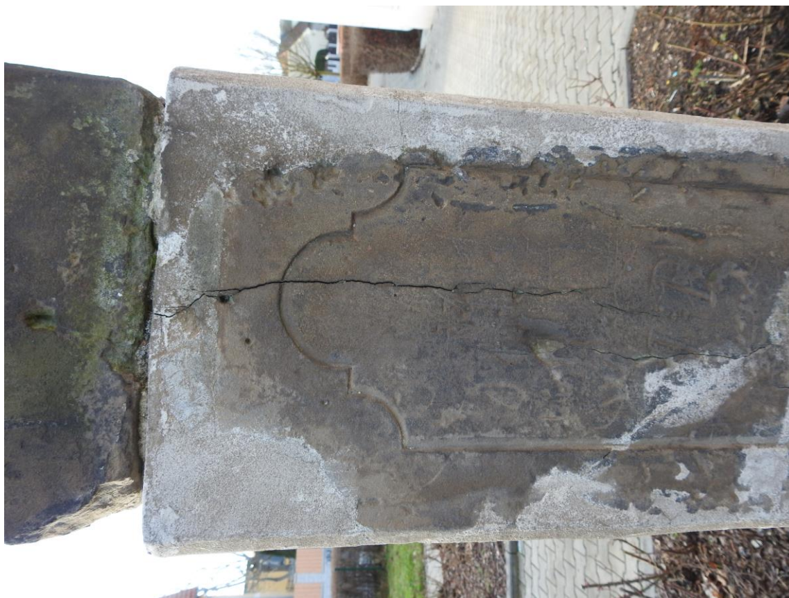
Praha-Dolní Chabry, pilíř se sochou sv. Václava, detail trhliny, modelačních doplňků a rytých graffiti v horní části pravé boční strany pilíře – stávající stav
