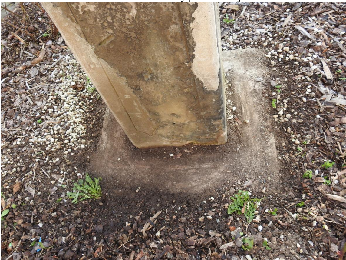
Praha-Dolní Chabry, pilíř se sochou sv. Václava, detail modelačních doplňků a rytých graffiti v dolní části zadní strany pilíře – stávající stav
