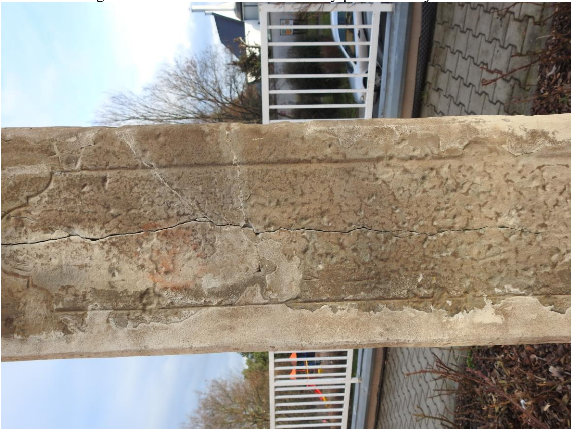
Praha-Dolní Chabry, pilíř se sochou sv. Václava, detail trhliny, modelačních doplňků a rytých graffiti ve střední části levé boční strany pilíře – stávající stav
