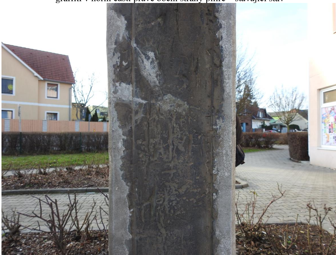
Praha-Dolní Chabry, pilíř se sochou sv. Václava, detail trhliny, modelačních doplňků a rytých graffiti ve střední části pravé boční strany pilíře – stávající stav
