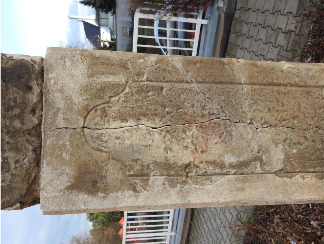
Praha-Dolní Chabry, pilíř se sochou sv. Václava, detail trhliny, modelačních doplňků a rytých graffiti v horní části levé boční strany pilíře – stávající stav
