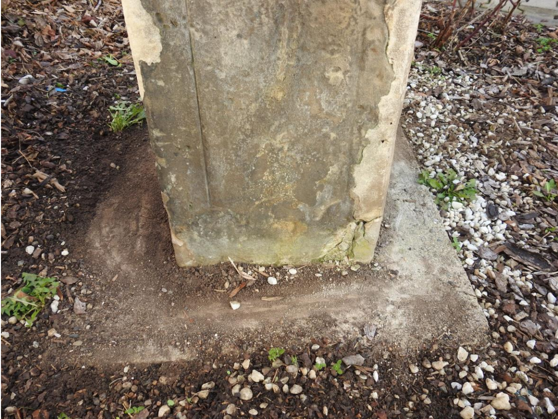
Praha-Dolní Chabry, pilíř se sochou sv. Václava, detail rozdrčení rohu a modelačních doplňků v dolní části levé boční strany pilíře – stávající stav
