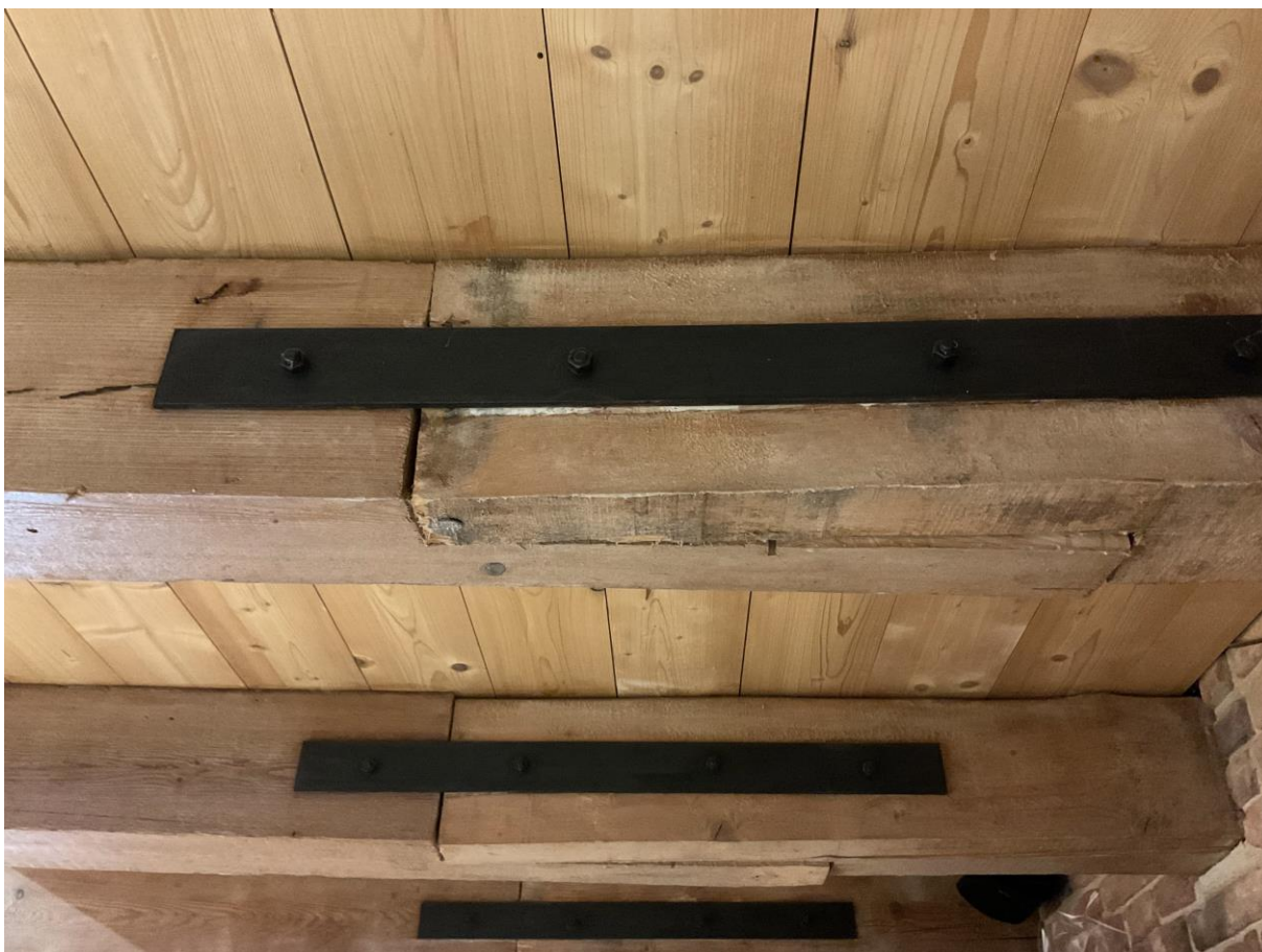
Obrázek 10 - Narušení statiky nosných trámů
