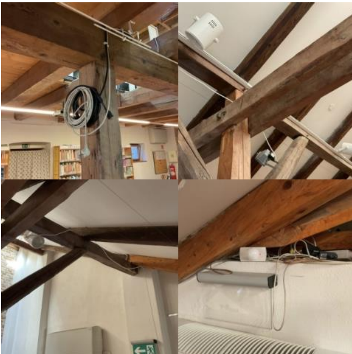
Obrázek 12 - Kabeláž, nedostačující situace osvětlení
